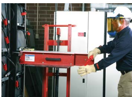
Большие ИБП для оптимальной производительности требуют проведения профилактики на месте установки
